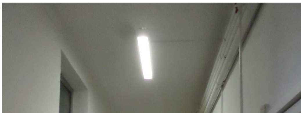
Figura 4.14 - Particolare dei corpi illuminanti installati a soffitto
