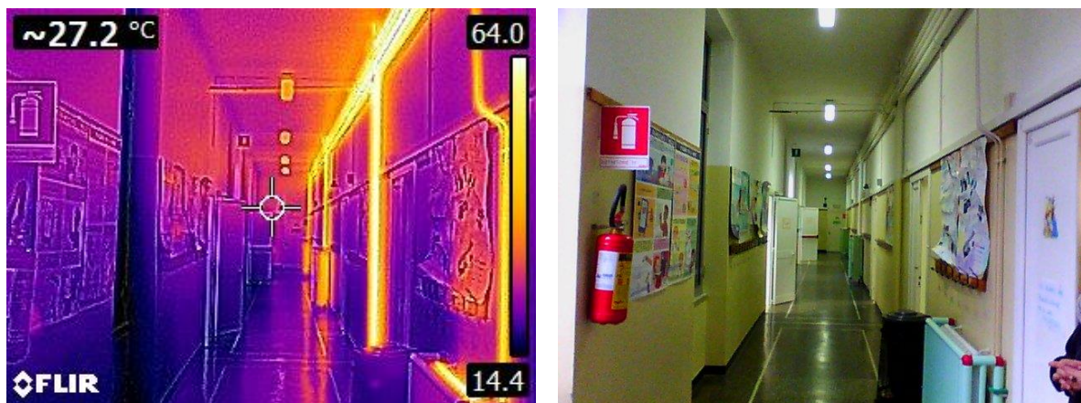
Figura 4.3 – Rilievo termografico della parete del corridoio del piano primo.
