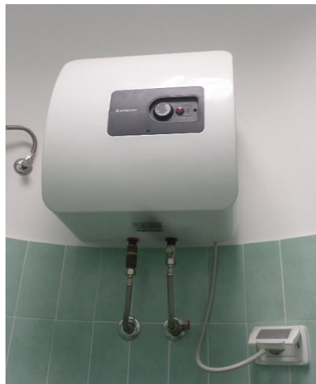
Figura 4.12 - Particolare di un boiler elettrico per la produzione di acqua calda sanitaria
