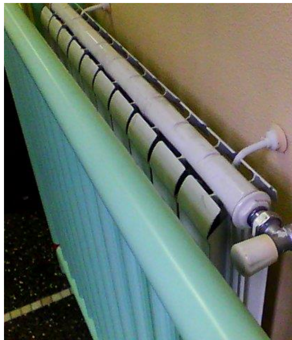
Figura 4.7 - Particolare dei radiatori in metallo
