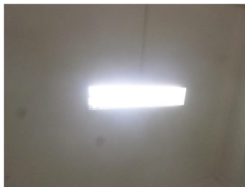
Figura 8.13- Particolare dei corpi illuminanti attualmente installati
