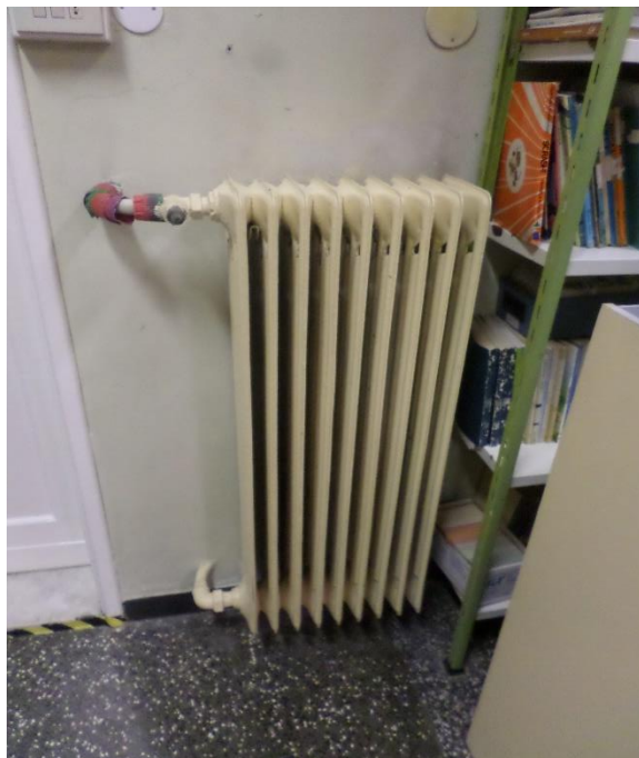
Figura 4.6 – Particolare dei radiatori in ghisa
