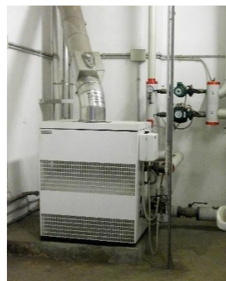
Figura 8.8- Particolare del generatore di calore attualmente installato
